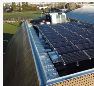
Amandiers. Idrottsanläggning. Carrierre sur Seine, Frankrike. ECOi-W.
